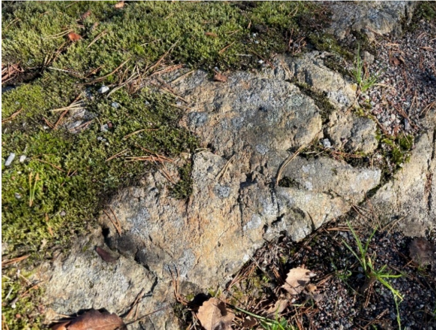
Figur 14. Rostutfällning på berghäll. Fotat 2024-09-20.
